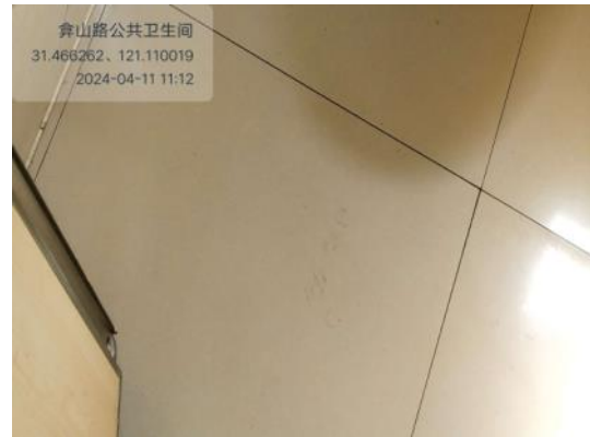
奔山路公共卫生间女厕室内地面有污迹
