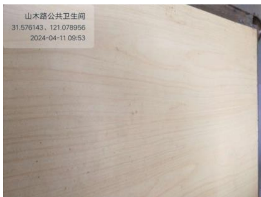
山木路公共卫生间女厕室内挡板未每天擦洗，有污迹
