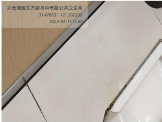
东方路与中市路公共卫生间女厕室内地面有污迹
