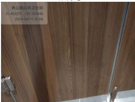
奔山园公共卫生间女厕室内挡板未每天擦洗，有污迹
