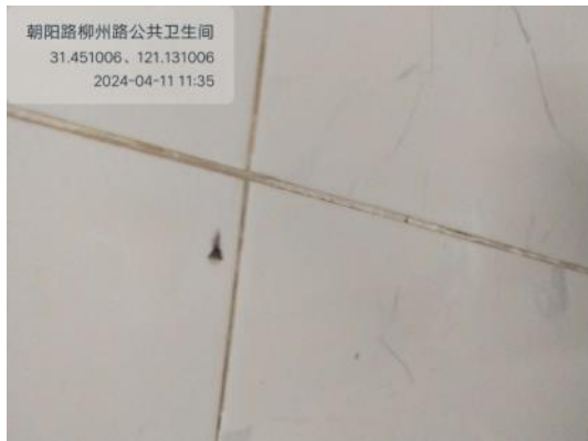
朝阳路柳州路公共卫生间男厕室内墙体未做到每月2次全面擦洗，有污迹
