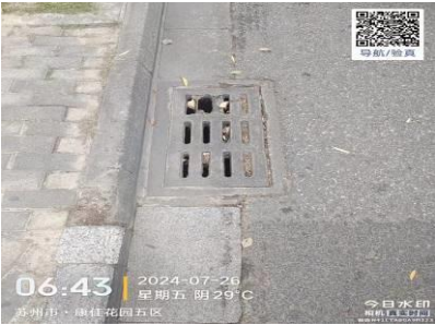
景山路-堵塞、破损
