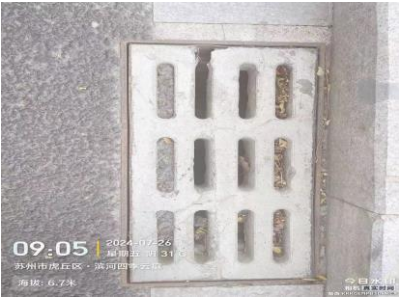
运河路-堵塞破损
