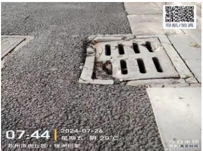
金鸡湖大道-下沉、破损
