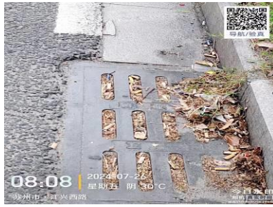
江兴大桥-堵塞
